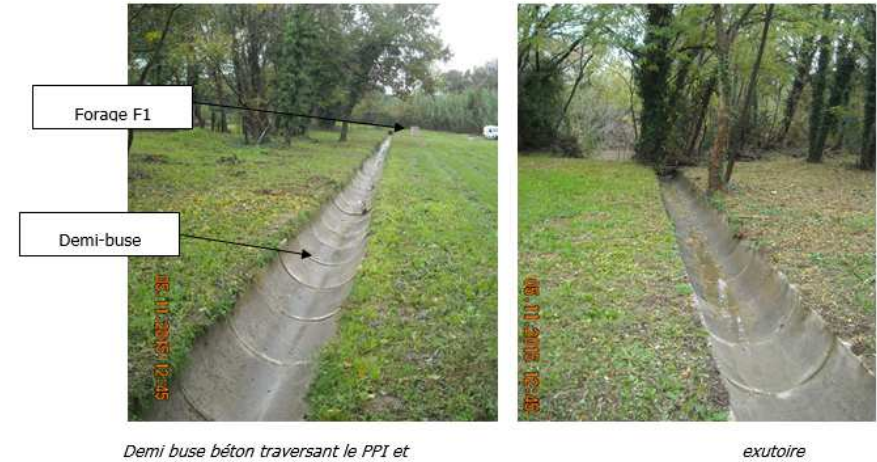
Demi buse béton traversant le PPI et
