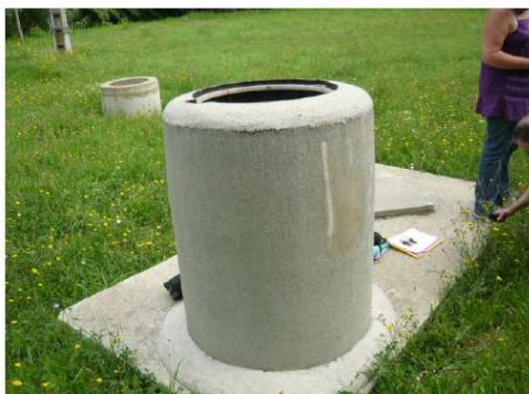
Regard d'exploitation du forage F1
